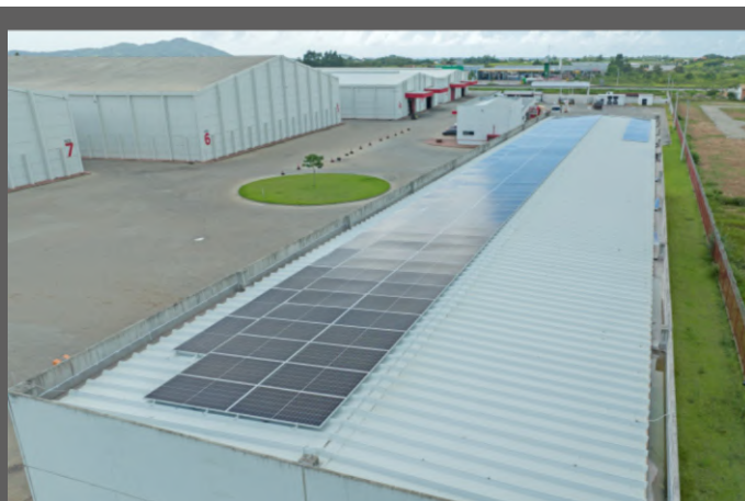
Painel Solar instalado no Centro de Distribuição de Imbituba.
